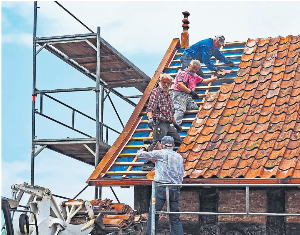
Aufdecken der Original-Tondachziegel: Die Männer der Haus-&-Hof-AG gehen sorgsam mit den wiederverwendbaren Bauteilen um.
