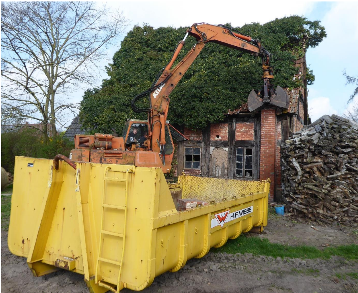
Beginn des Abbaus im April 2017. Der für die Flüchtlinge gebaute Schornstein wird vorsichtig von der H. F. Wiebe Stiftung abgetragen.
